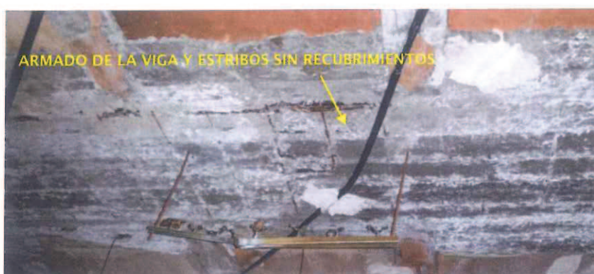
Falta de recubrimiento del armado de vigas planas y signos de oxidación.
