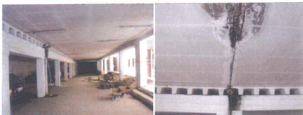
Filtraciones y corrosión de las armaduras en junta de dilatación de losa armada. Planta sótano: zona de paso y aparcamientos
